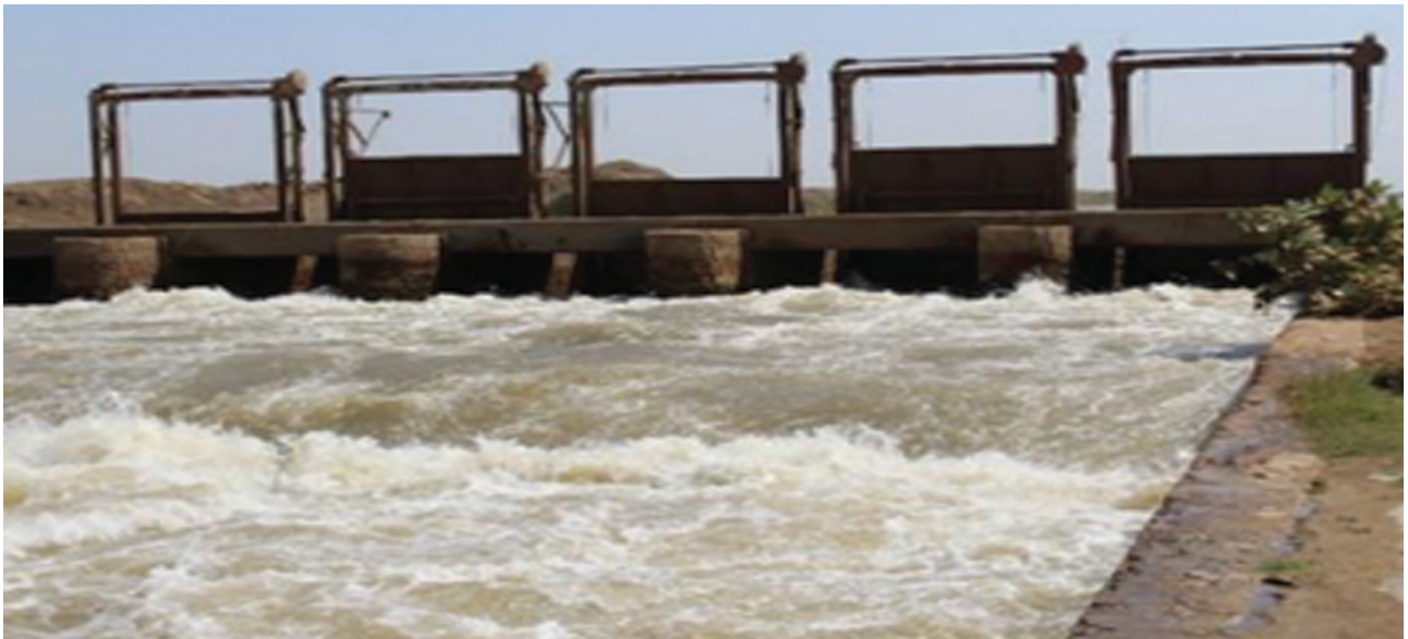
بوابات (RSG)-Roller Sluice Gate
